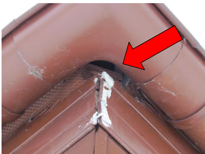
Vadné provedení okapnic a větracích pásů střešního pláště. Vlivem chybně provedených okapnic dochází k zatékání do konstrukce palubkového podhledu a jeho degradaci – stav po 4 letech stáří objektu.
