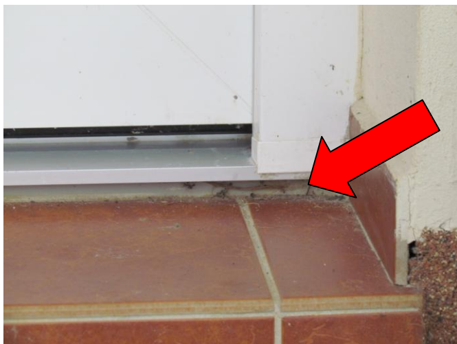
Tepelný most pod prahem vstupních dveří
