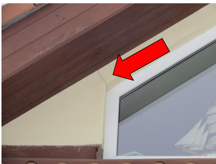
Prasklina v nejužším místě překladu patrně vlivem nesprávného nadimenzování či uložení výztuže, nicméně nepředpokládám další zhoršování stávajícího stavu
