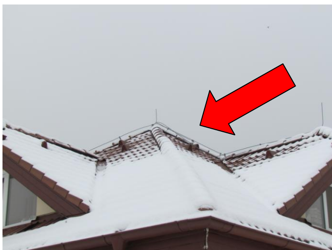
Vadné ukončení difuzních folií, obdobné závady se dají předpokládat i v provedení v ploše, hrozí zatékání kondenzátu do tepelných izolací
