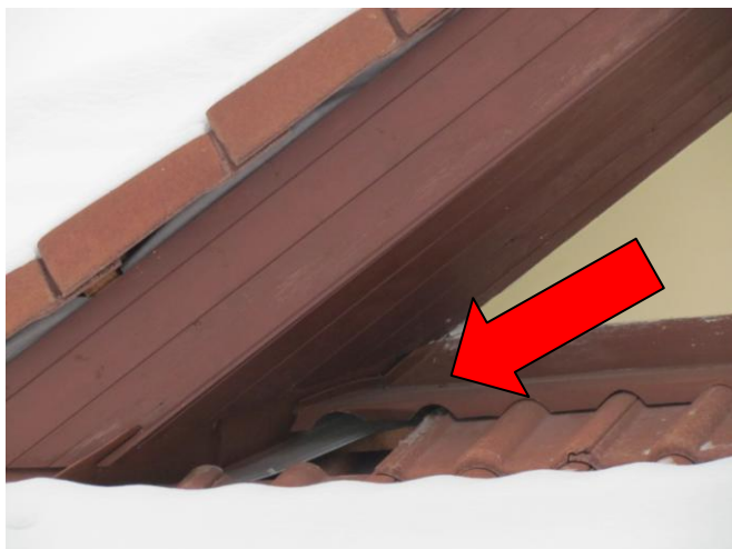
Vodorovné hydroizolace v úrovni vrchního líce zpevněných ploch, hrozí pronikání vlhkosti do objektu. Doporučuji provedení svislých hydroizolací nopovými foliemi dle popisu v textu
