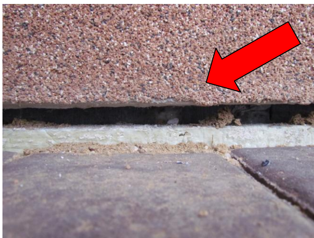
Několika centimetrová mezera mezi jednotlivými deskami EPS perimetr v zateplení základových pásů a soklu RD –tepelný most. V opravě postupovat dle popisu v textové části. Zjištění tl. 30 mm u zateplení základových pásů v rozporu s návrhem PD
