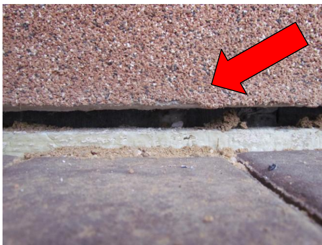
Provedení sondy do střešního pláště na styku se štítovým zdívem arkýřů. Bylo zjištěno použití izolace v tl. dle návrhu PD. Byla shledána nesprávná aplikace na styku se zdívem, kde vzniká až 50 mm široká mezera bez izolantu – tepelný most. Rovněž byly zjištěny nedostatky v provedení difuzních folií v detailech. Použití parozábran na vnitřním líci střešního pláště je v pořádku, přelepení spojů jednotlivých pásů či na prostupech instalací nebylo z provedené sondy zřejmé.
