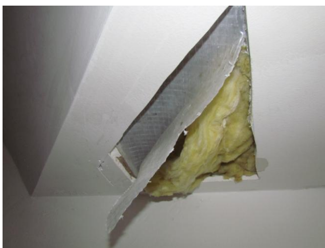
Stopy po kondenzaci vlivem nesprávně aplikované minerální vaty ve střešním plášti v kritickém detailu okolo pozednic
